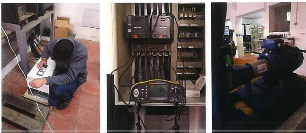
Figura 7 – Manutenção dos equipamentos é essencial para garantir o correto funcionamento das infra estruturas.
