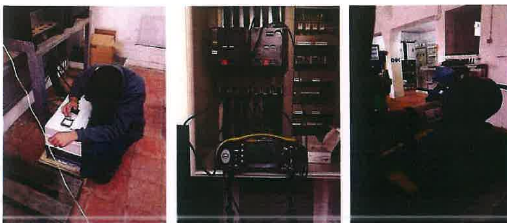
Figura 7 – Manutenção dos equipamentos é essencial para garantir o correto funcionamento das infra estruturas.
