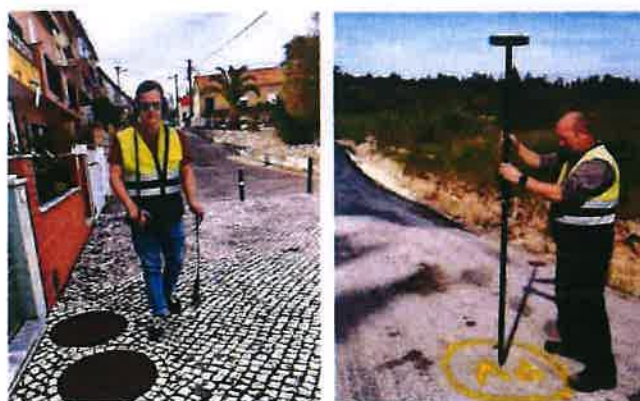
Figura 6 - A equipa de deteção de fugas faz o mapeamento das situações críticas
