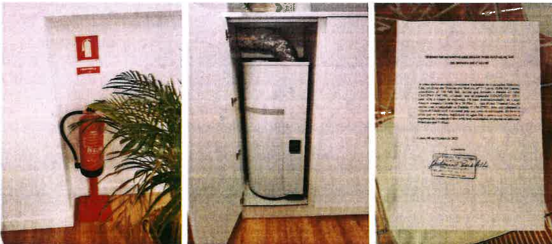
F7, F8 e F9 – Extintor; bomba de calor; termo de responsabilidade pela instalação da bomba de calor
