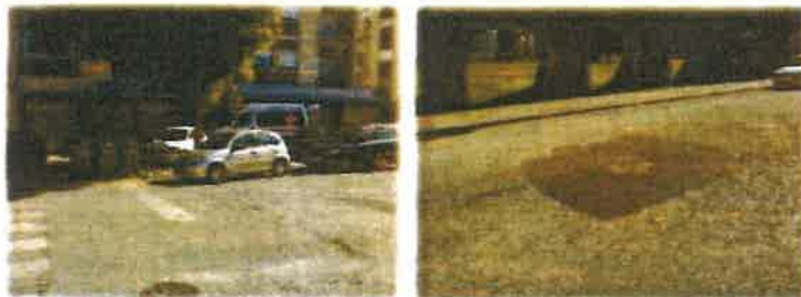
Fig. 4 – Camada de desgaste defeituosa em toda a extensão do arruamento
