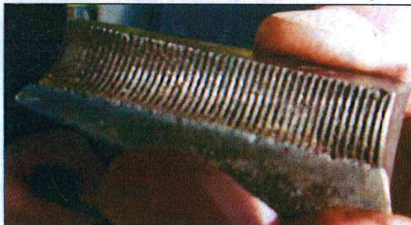
Figura 2.6 – Pormenores das anomalias das cunhas interiores do macaco
