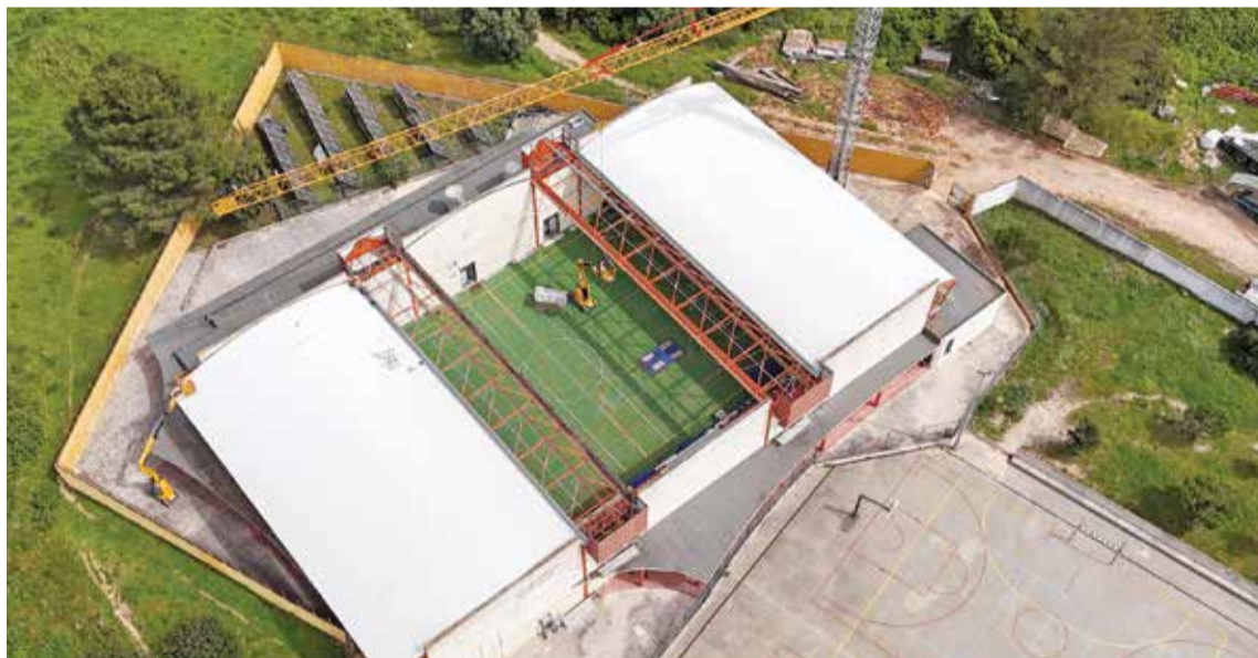
O Pavilhão João dos Santos está a receber novas condições, nomeadamente a substituição integral da cobertura
