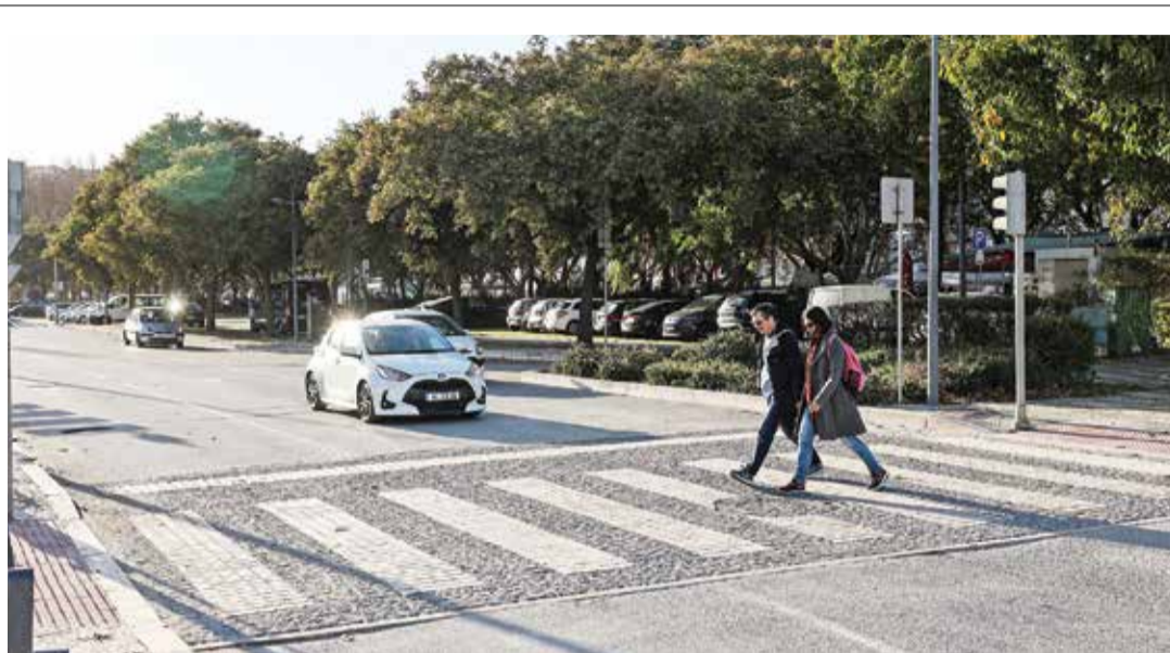
Todas as passeadeiras em pedra na Avenida Luísa Todi estão a ser recuperadas
