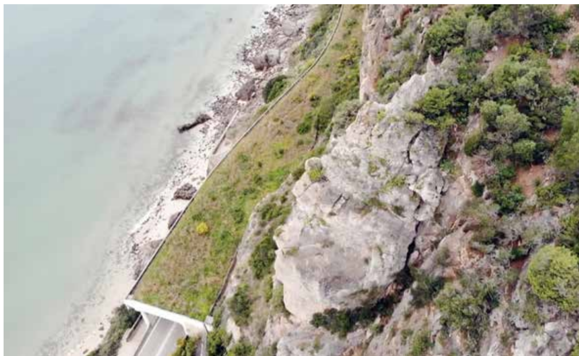
O bloco rochoso em risco de queda na estrada da Arrábida terá um peso superior a mil toneladas
