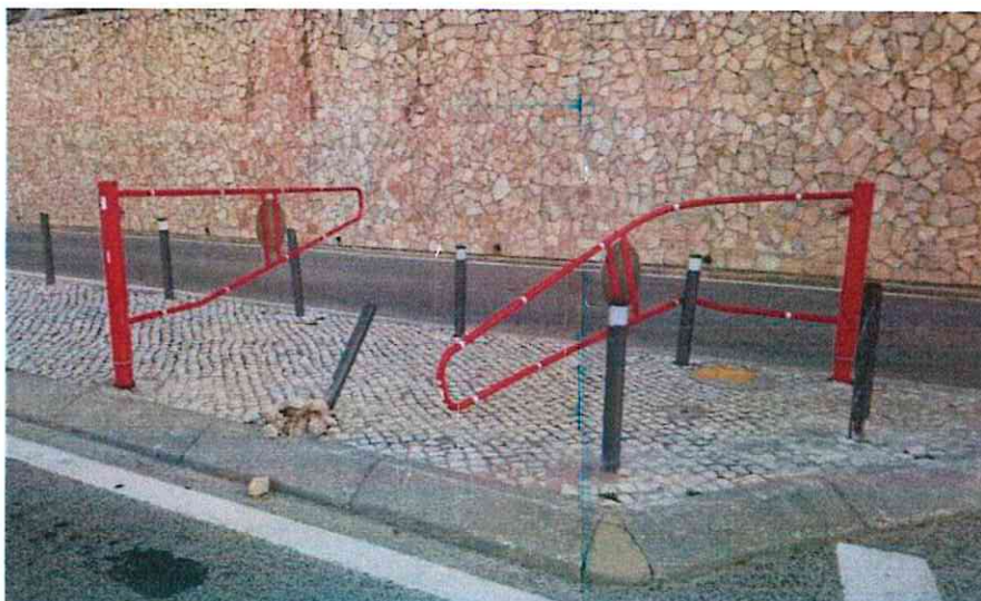
Figura 23 - Registo dos atos de vandalismo nos equipamentos instalados.
