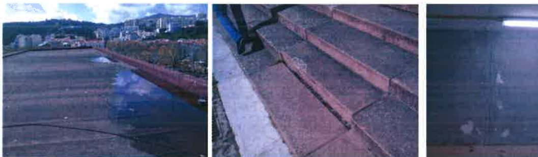
Fig. 1 – Infiltrações pelo pórtico, pátios exteriores e consequente degradação interior de pinturas
