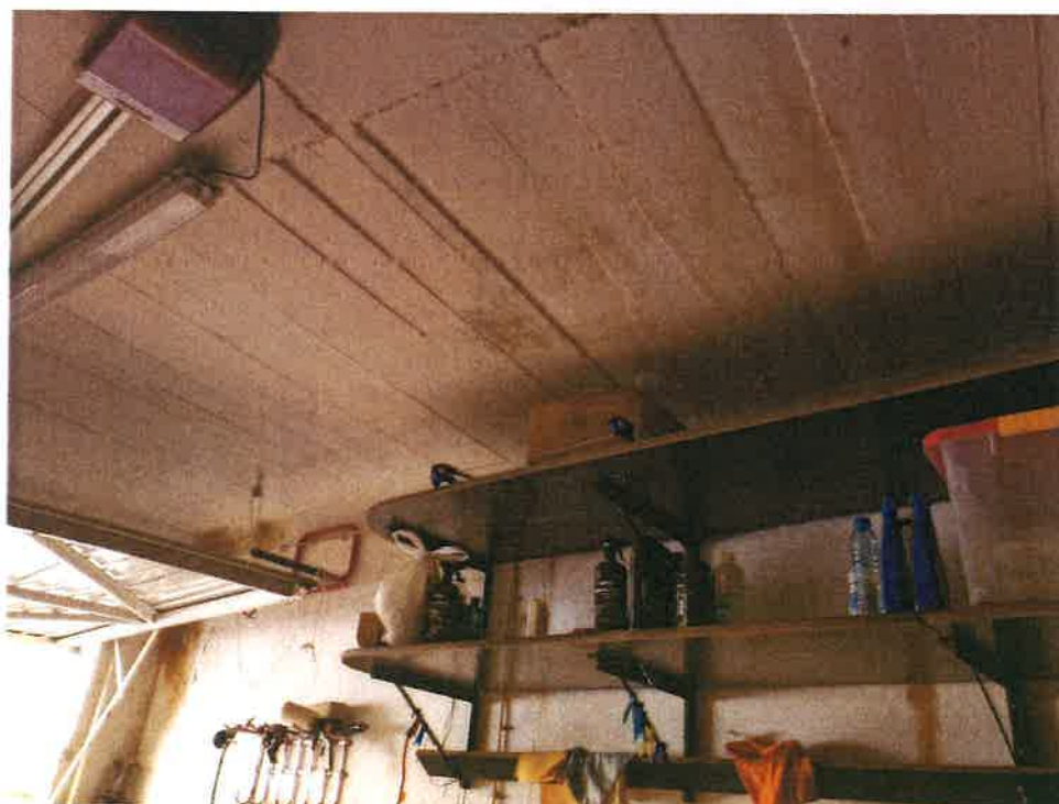
(foto 9) – Interior da garagem 1 – Infiltrações no teto
