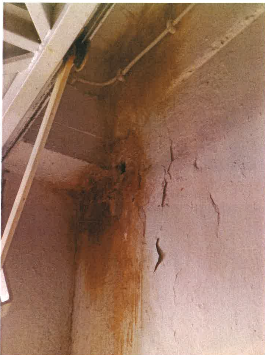
(foto 10) - Interior da garagem 1 – Infiltrações no teto e paredes
