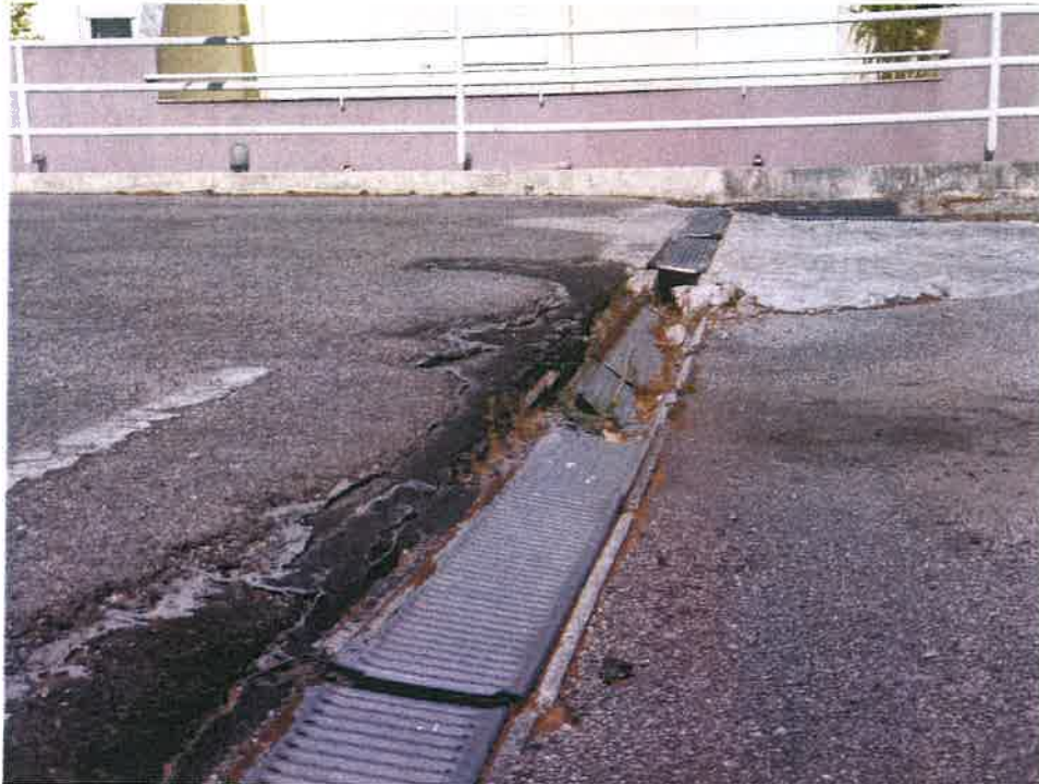
(foto 3) – Grelha de drenagem pluvial - Estacionamento descoberto – zona comum
