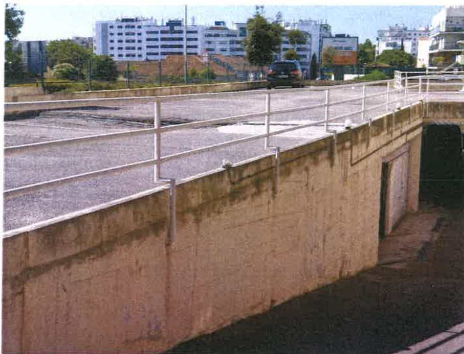
(foto 8) – Enquadramento da garagem 1 com a Grelha de drenagem pluvial do Estacionamento descoberto
