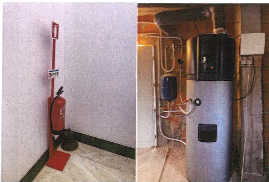
Foto 26 – Extintor nas escadas do 1º piso e Bomba de calor situada no sótão
