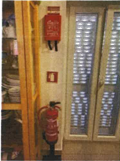
Foto 15 – Manta fixada e extintor em suporte
