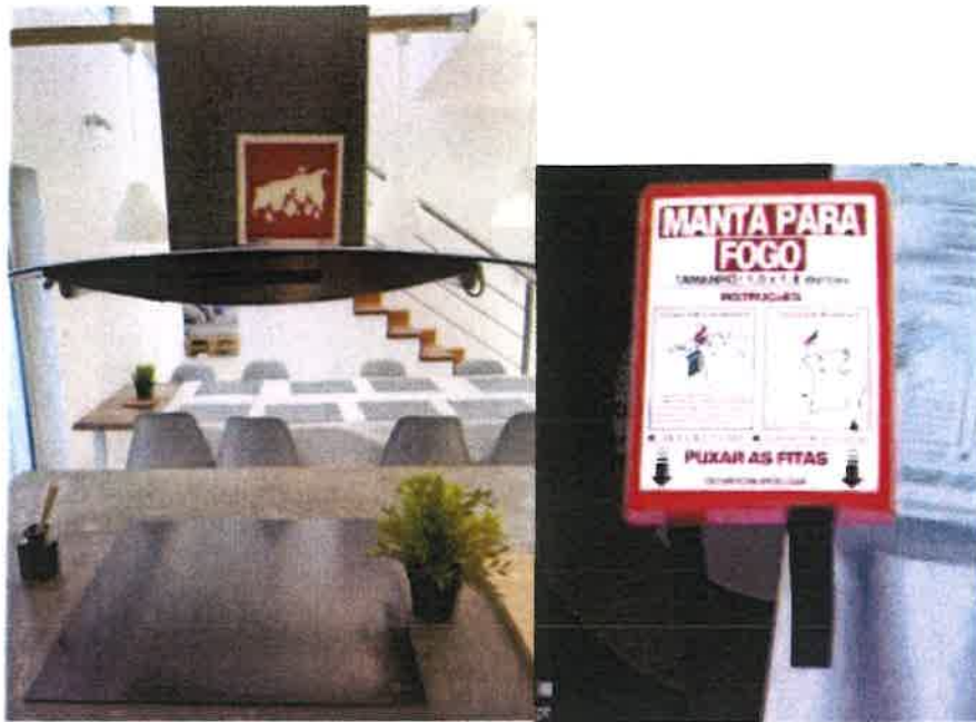
Foto 6 e 7 – Simbologia e manta apaga fogos não estava colocada
