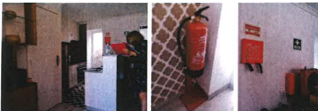
F4, F5 e F6 – Sala/cozinha; extintor; manta de incêndio e kit primeiros-socorros
