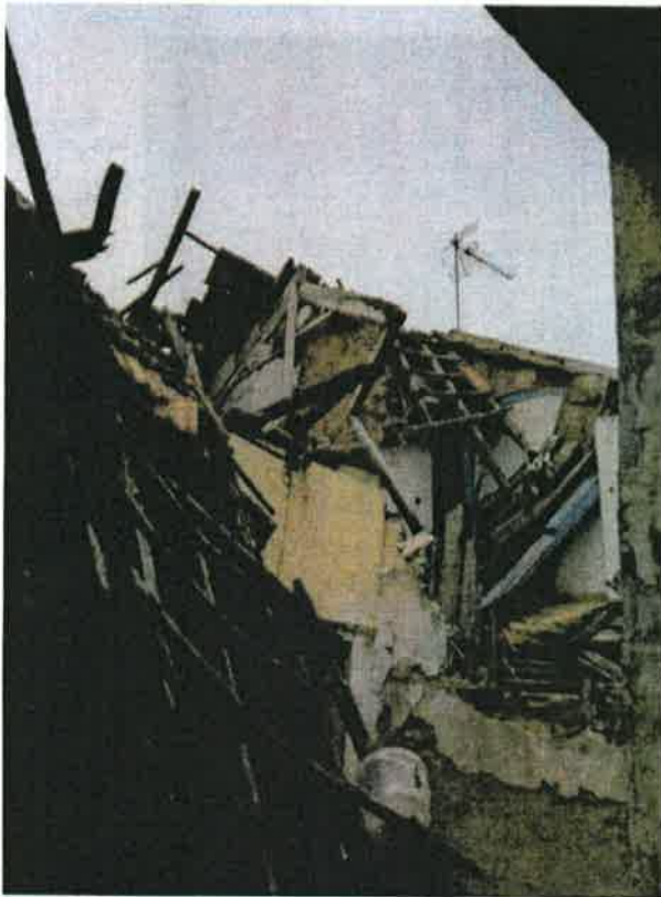
Foto 3- Imóvel nº 31- cobertura ruída
