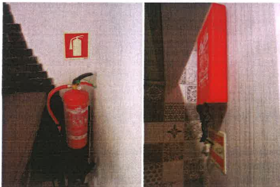
Foto 5 e 6 - Extintor e manta ignífuga
