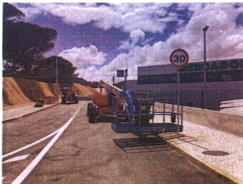
(foto 10) – Via de ligação – Fase 0 - Acesso Sul – sinalização vertical
