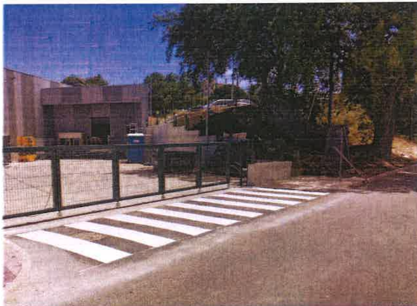
(foto 12) – Acesso Oeste – R. Vieira da Silva – sinalização horizontal
