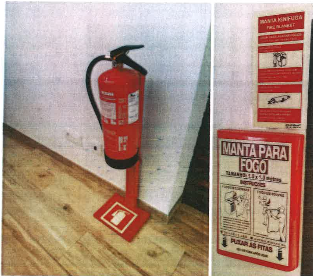
Foto 12 e 13 – Extintor e manta ignífuga
