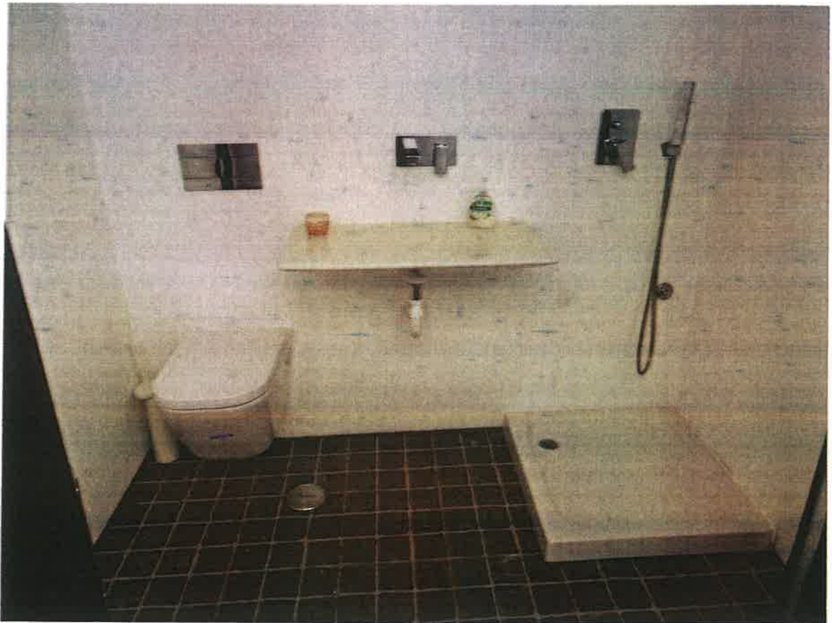
Foto 16 – IS de apoio à Piscina
