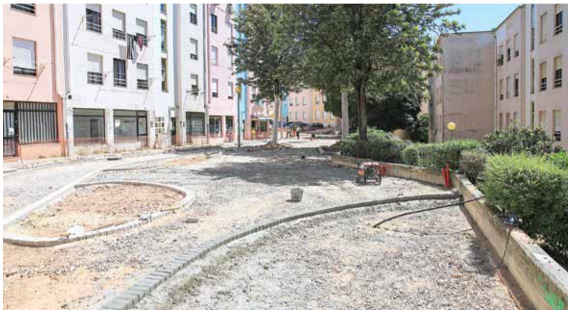
Obra requalifica espaço público na Quinta dos Vidais e melhora as condições de mobilidade
