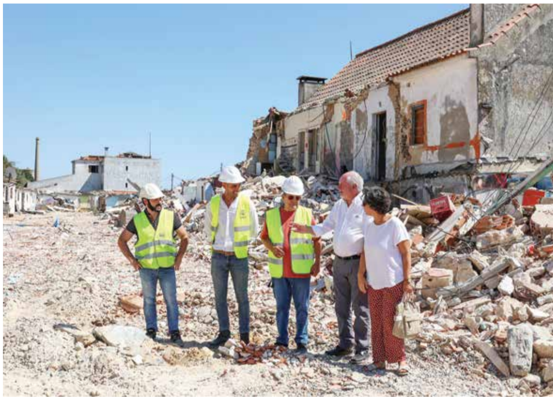
O presidente e a vice-presidente da Câmara, André Martins e Carla Guerreiro, acompanharam a operação de demolição
