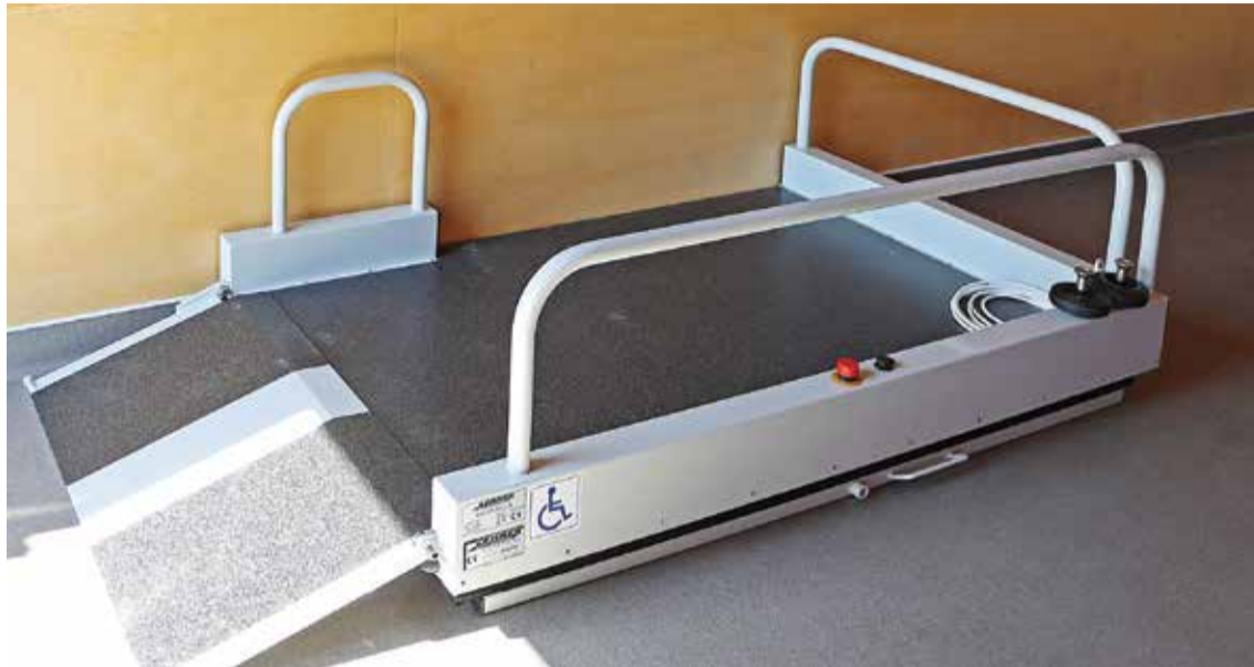
Uma plataforma elevatória torna o Auditório Bocage mais acessível
