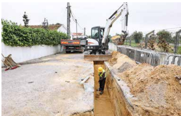
O prolongamento do saneamento é uma reivindicação antiga na Mourisca
