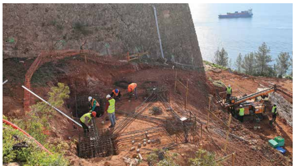
A CONSOLIDAÇÃO ESTRUTURAL DAS ENCOSTAS DO FORTE DE SÃO FILIPE ESTÁ A DECORRER
