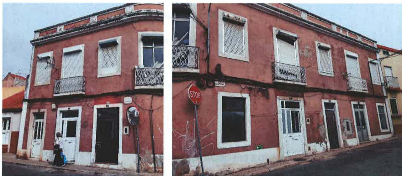
Foto 03, 04 – Vista do imóvel com necessidade de intervenção
