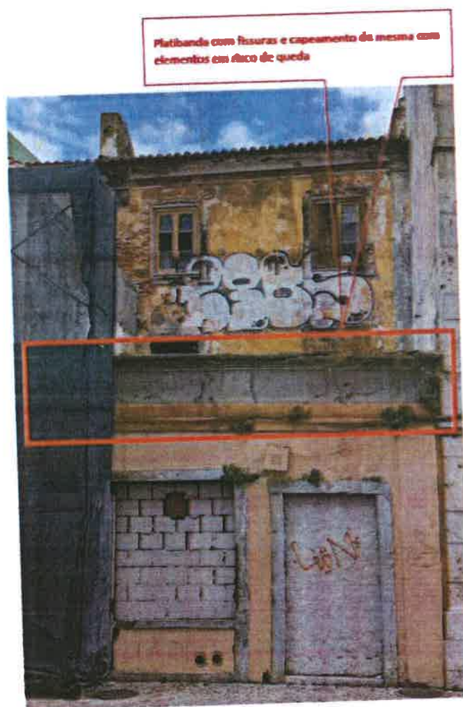
Foto 3 – Platibanda com fissuras e capeamento da mesma com elementos em risco de queda
