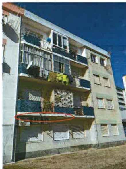
Fachada Posterior – Zona com queda de reboco
