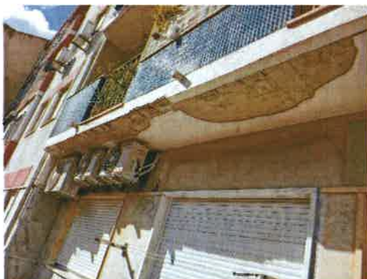
Fachada Posterior – Zona com queda de reboco
