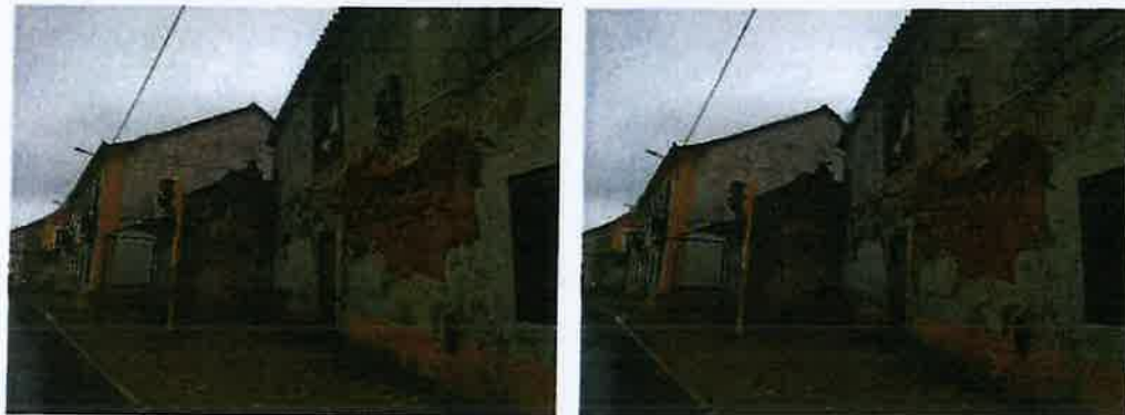
Fotografias 01 e 02 - Registo de 03/02/2026 – Fachada em avançado estado de degradação sito na Rua 25 de Abril n.º 20, Aldeia de irmãos, União de Freguesias de Azeitão, em Setúbal.
