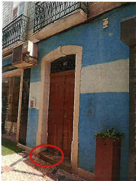
Fotos nº1 – Entrada do edifício pelo nº10, com escorrência de água para a via pública
