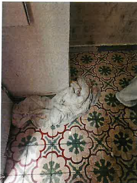
Foto nº3 – Hall de entrada com presença de água
