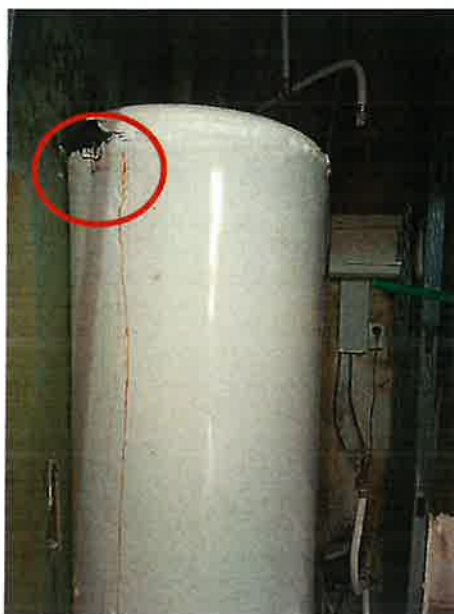
Foto nº6 – Novo “remendo” efetuado no termoacumulador
