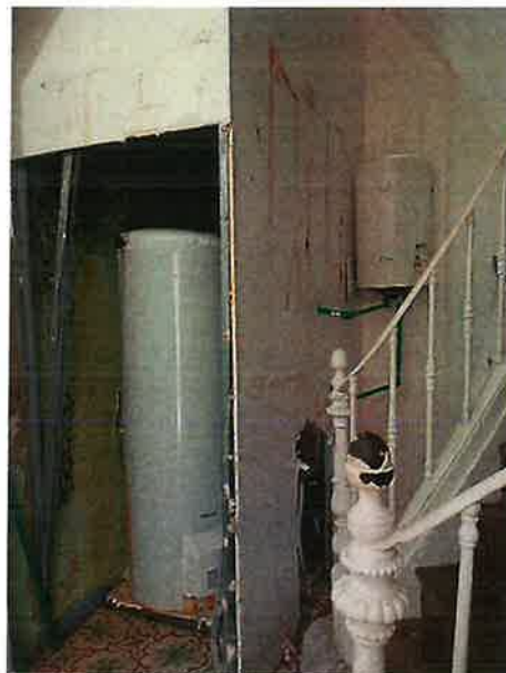
Foto nº4 – Zona dos termoacumuladores
